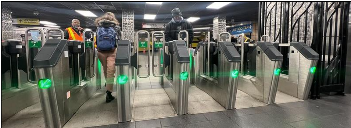
Current Pilot Gates at Sutphin Blvd-Archer Av EJZ
